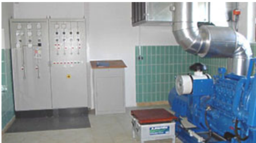
Innenraum Maschinenhaus mit Notstromaggregat
